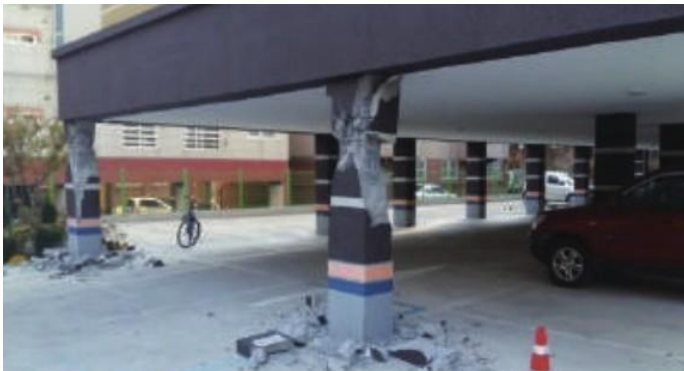
① 2017.11 포항 지진 필로티 기둥 파괴
