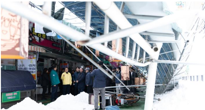
④ 2024.11 수도권 대설 시장 아케이드 붕괴
